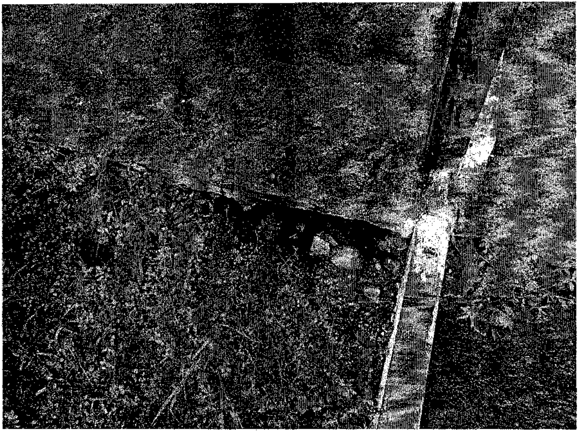
Фото 4. Отмостка здания. Размытие грунта под отмосткой здания.
